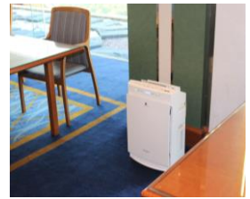
新たに空気清浄機を10台設置しております
