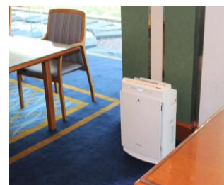
<レストラン> 空気清浄機を10台設置 しております。
